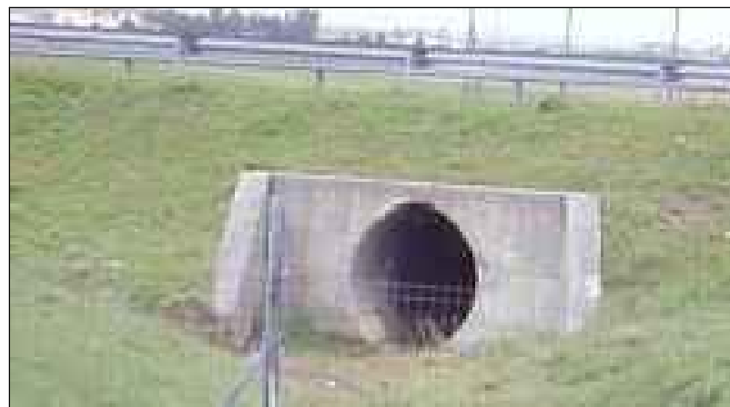
Foto di un tunnel di drenaggio delle acque che può fungere anche da attraversamento faunistico (foto M. Dinetti)
