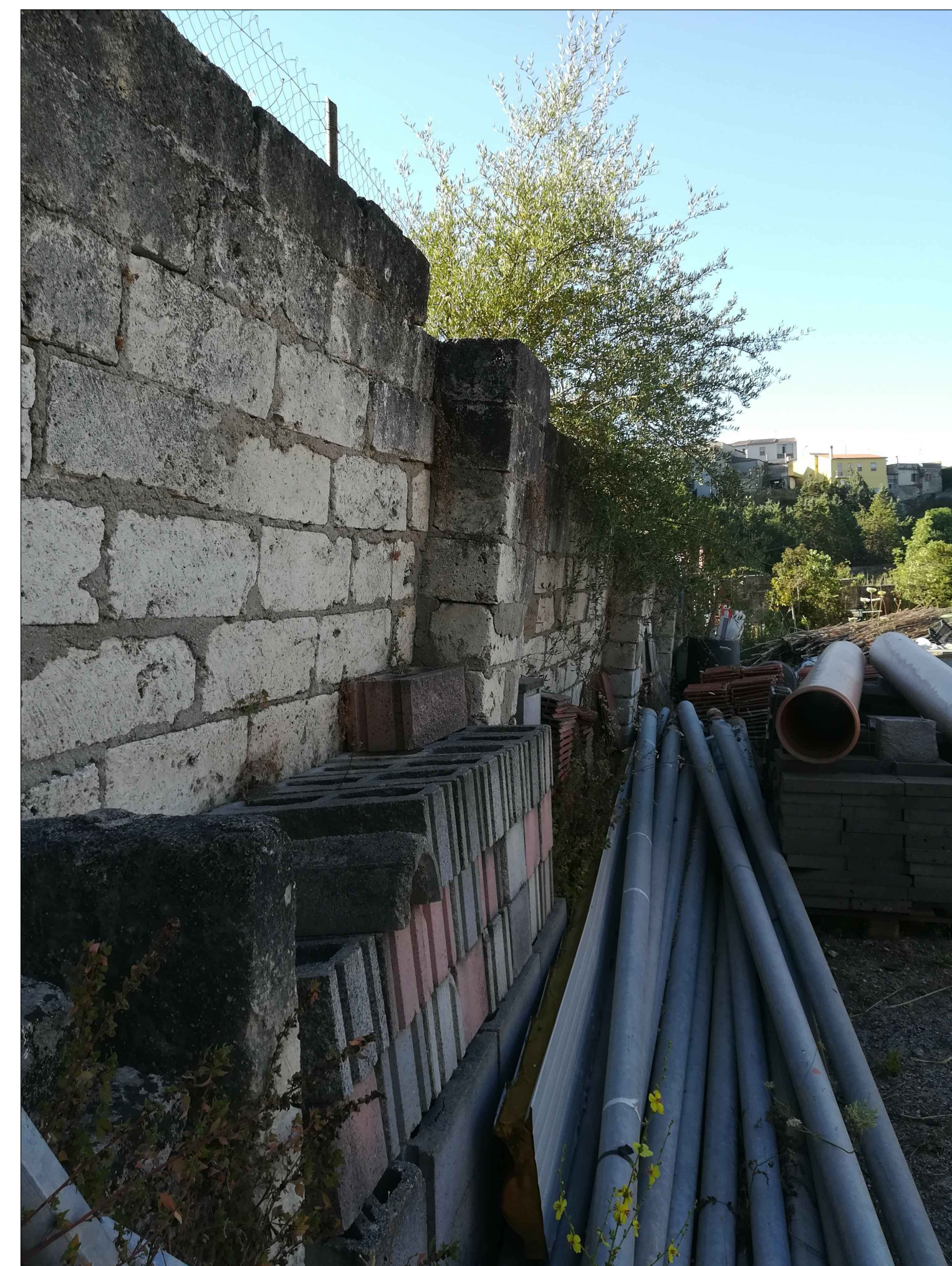
Muro di recinzione soggetto alla spinta del terreno retrostante da demolire e ricostruire
