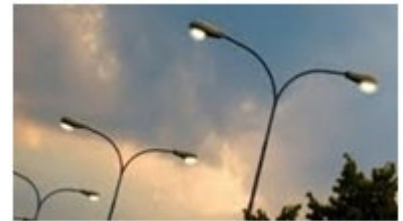
IMPIANTO DI PUBBLICA ILLUMINAZIONE S'ISCAMEDDU
